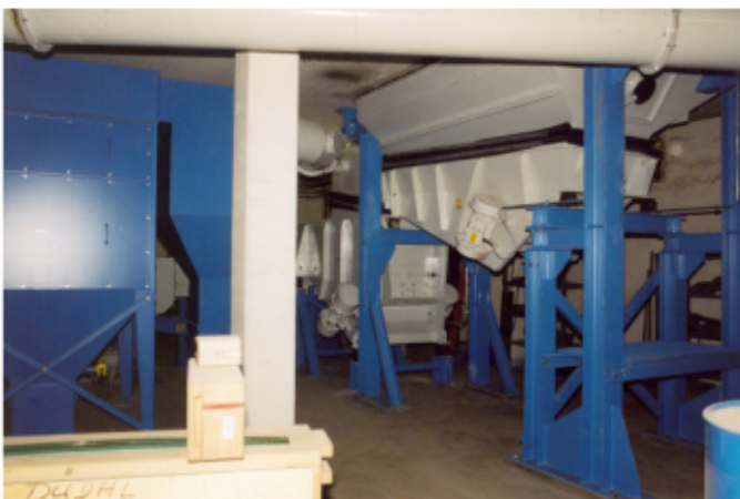
Filteranlage, Puffertrichter und Rinne
